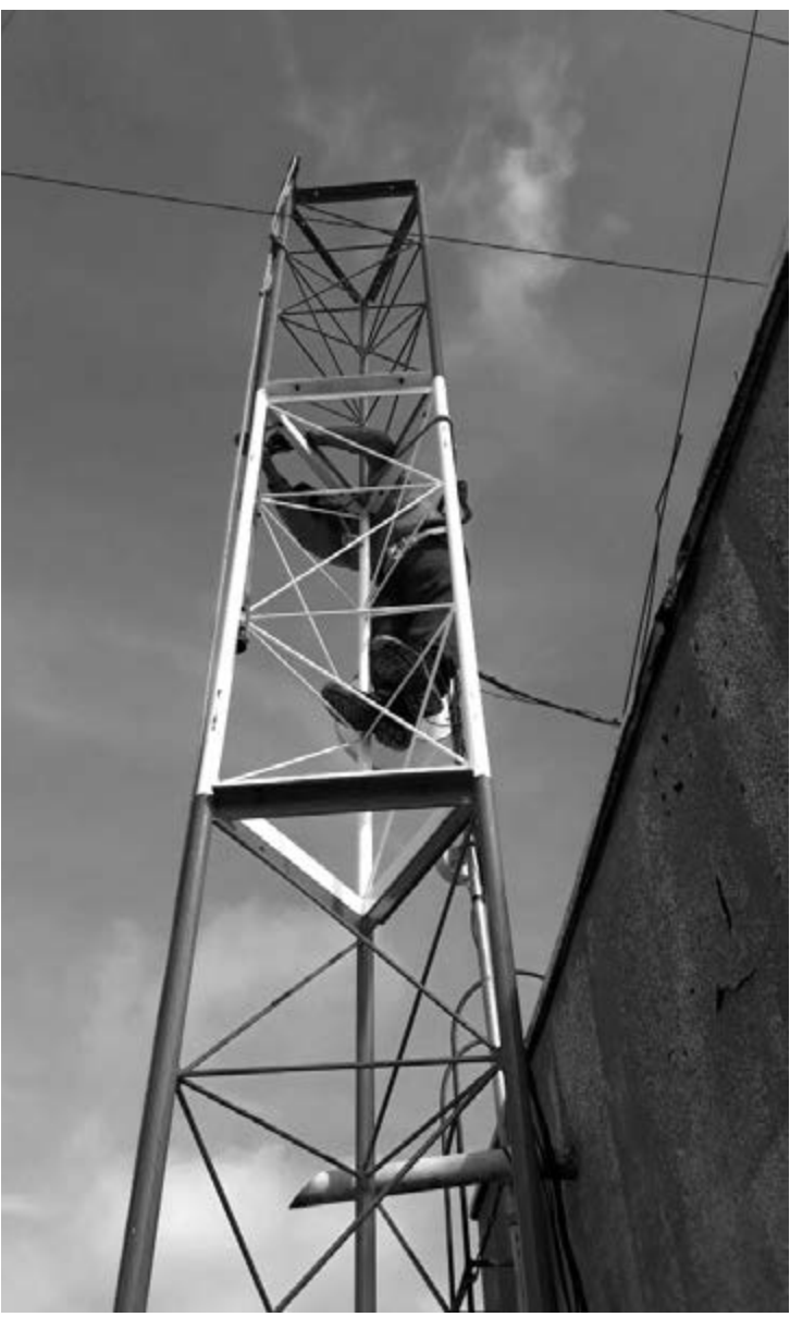
Equipamentos foram instalados para transmissão do sinal HD e hoje somos o segundo canal em Tangará da Serra a ter essa tecnologia (...) fazemos história a ser o segundo a ter essa tecnologia”.
