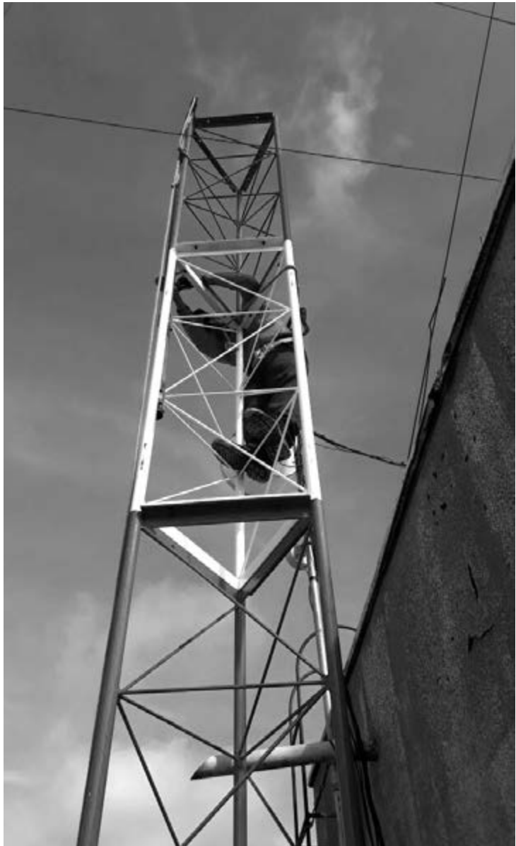
Equipamentos foram instalados para transmissão do sinal HD
