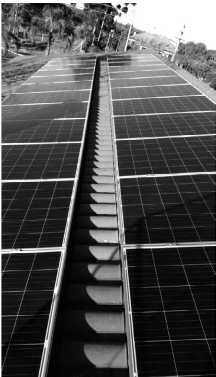
Sistema Solar Fotovoltaico
