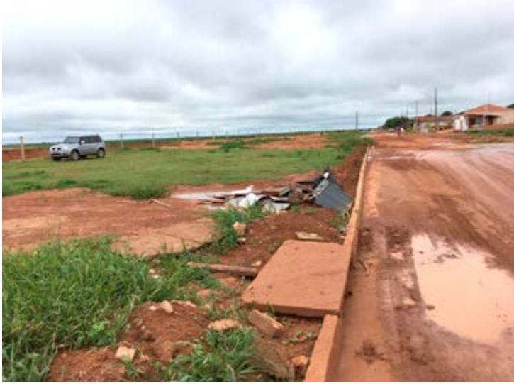
Problemas em drenagens foram identificados
