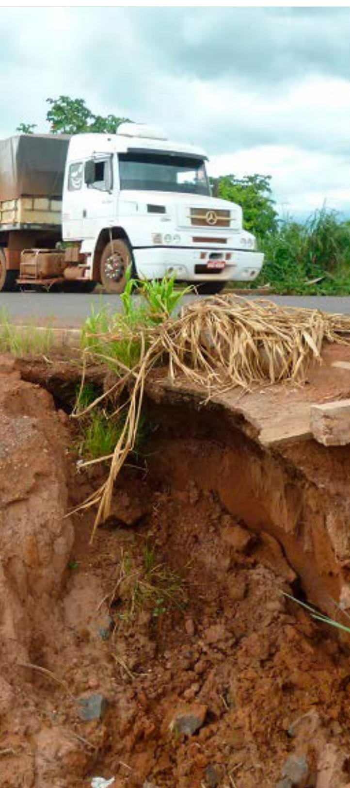
Erosão a quatro quilômetros do rio do Sapo
