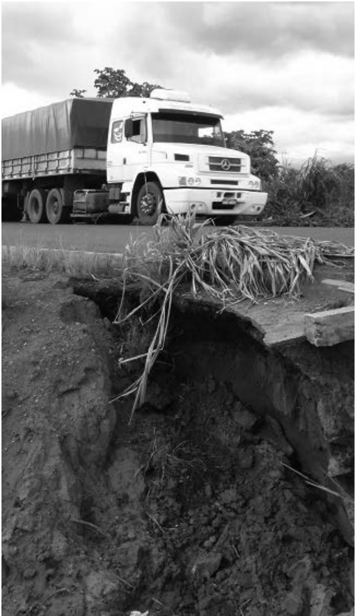
Erosão a quatro quilômetros do rio do Sapo
