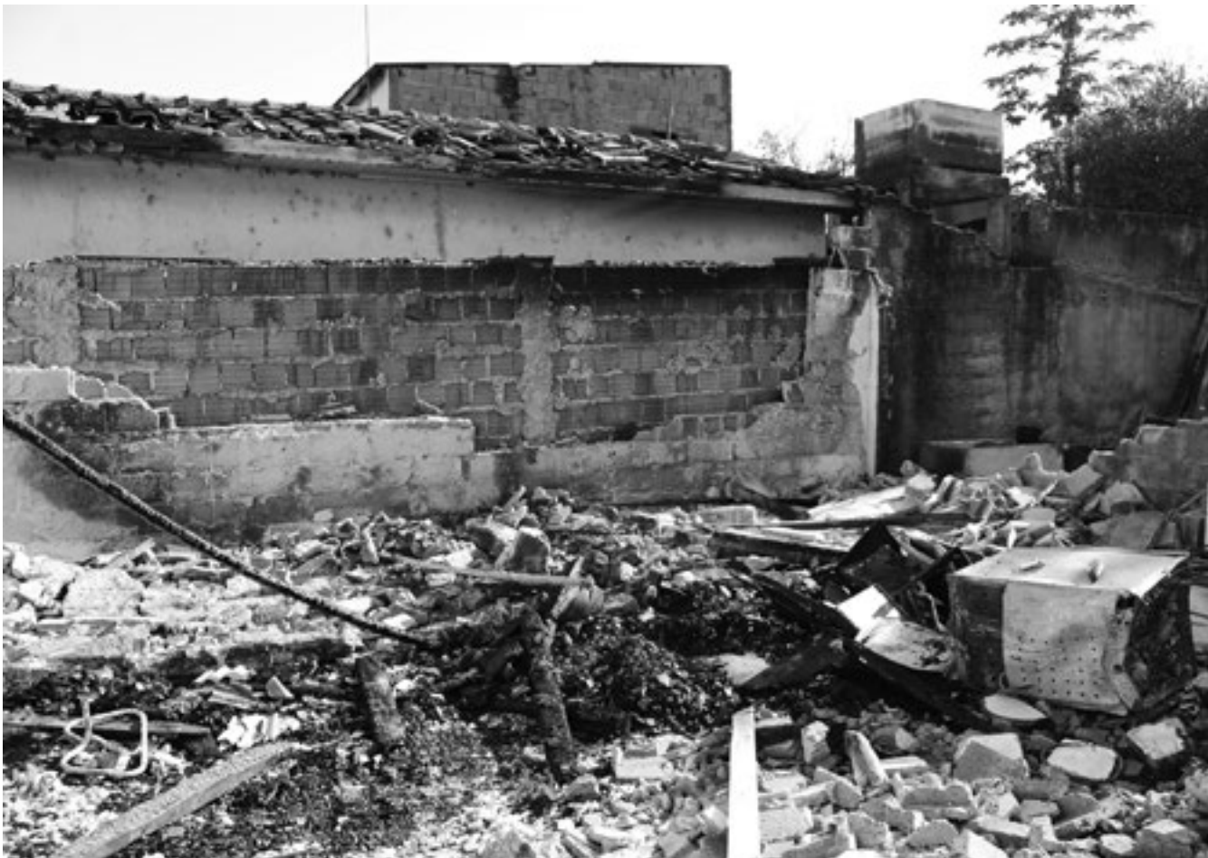
A situação só não foi ainda pior porque os moradores se reuniram rapidamente para conter o fogo, evitando que ele espalhasse
