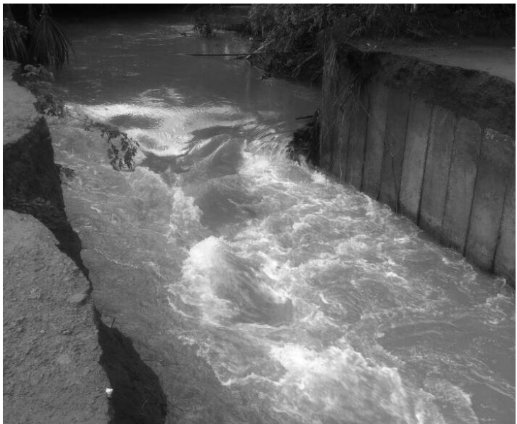
Enxurradas provocaram pontos críticos no município
