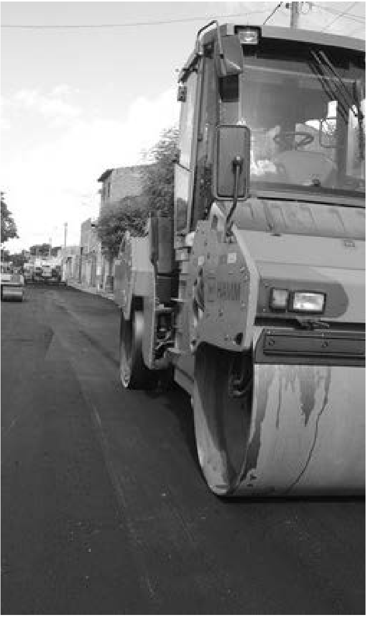
Ação pede pavimentação asfáltica em loteamento
