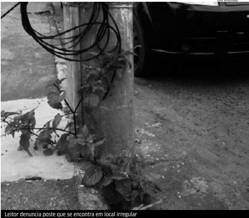
Leitor denuncia poste que se encontra em local irregular
