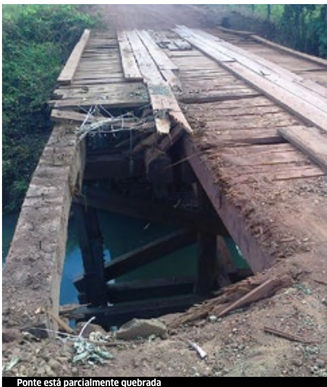
Ponte está parcialmente quebrada
