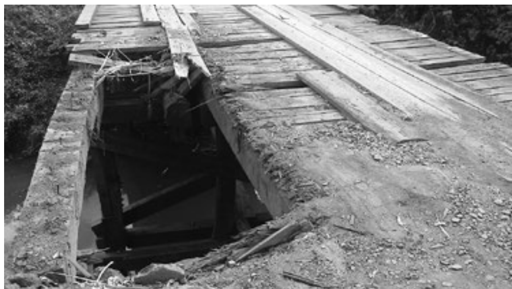
Ponte está parcialmente quebrada
