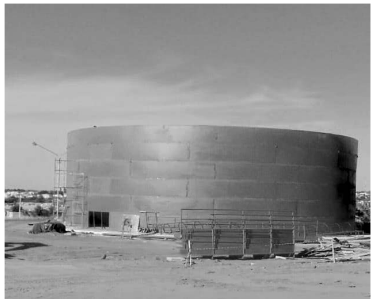
Depósito para 3 milhões de litros de água tratada
