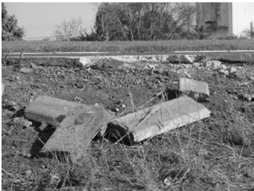
Meio-fio quebrado, buracos, placas ao chão são alguns dos problemas
