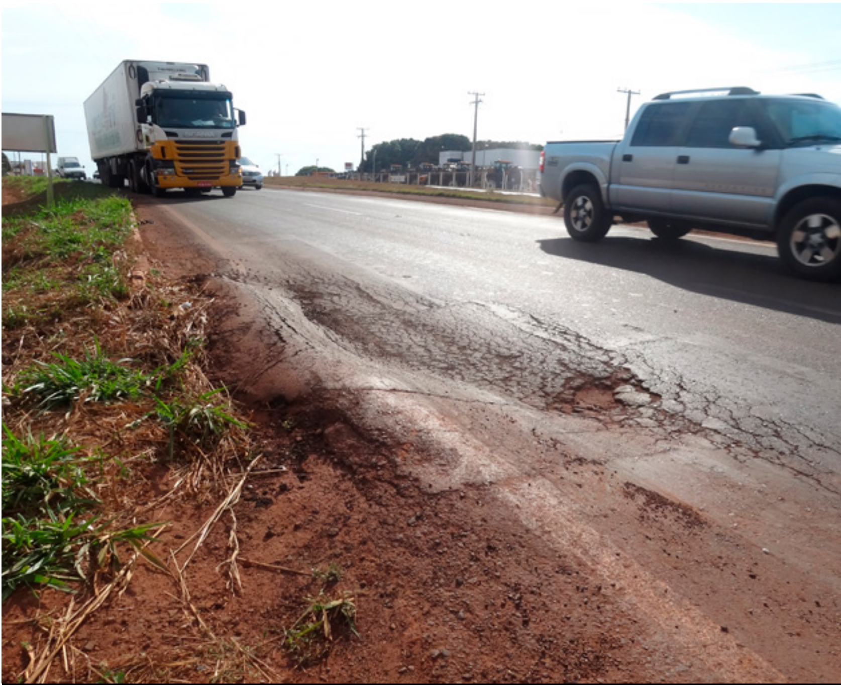
Meio-fio quebrado, buracos, placas ao chão são alguns dos problemas
