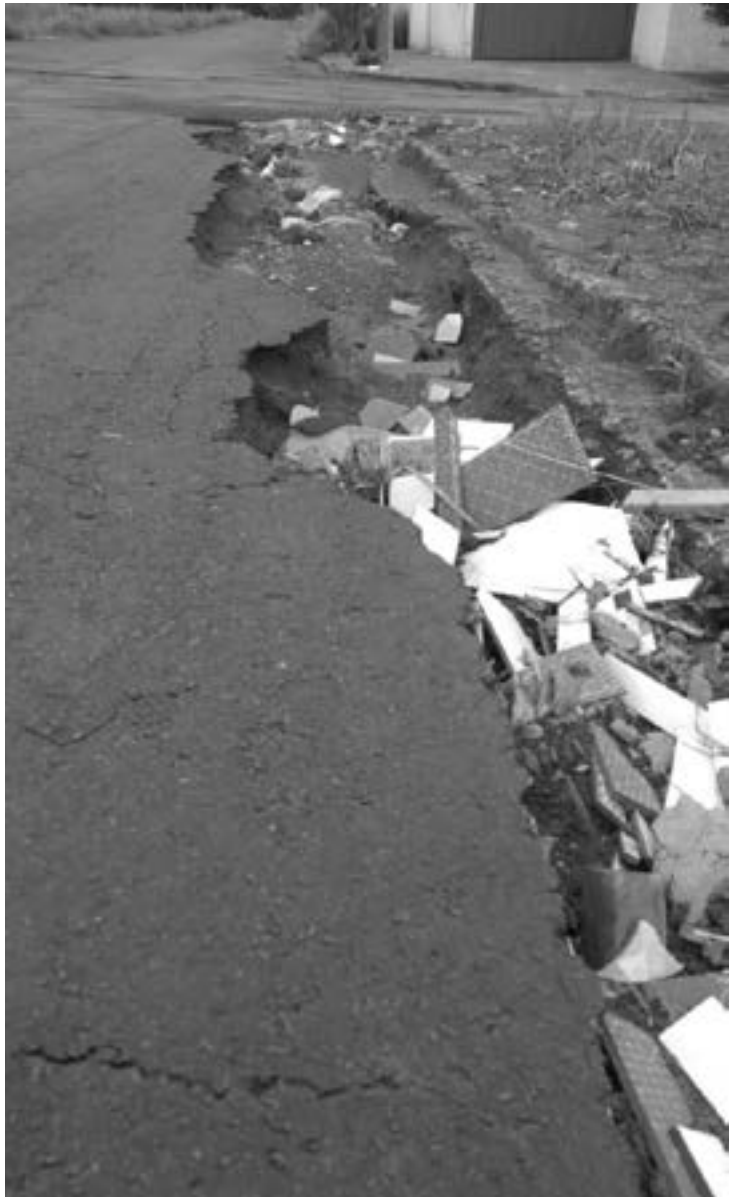
Todo o bairro está tomado por buracos
