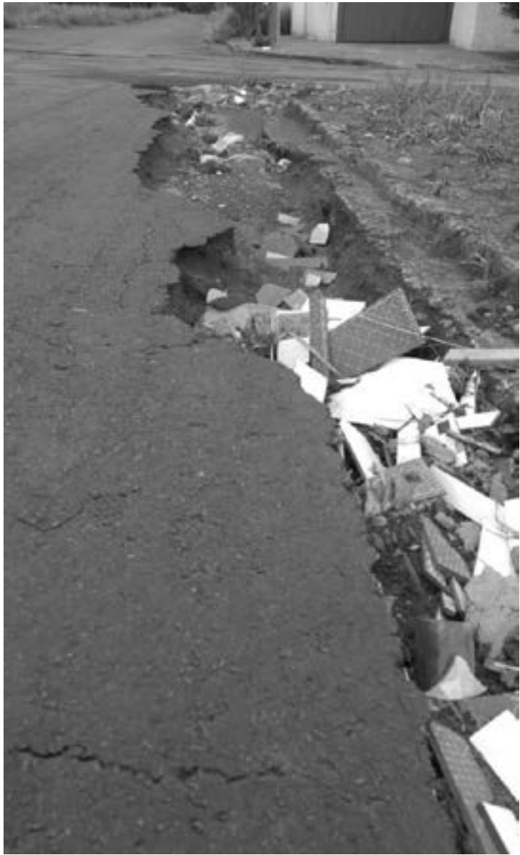
Todo o bairro está tomado por buracos
