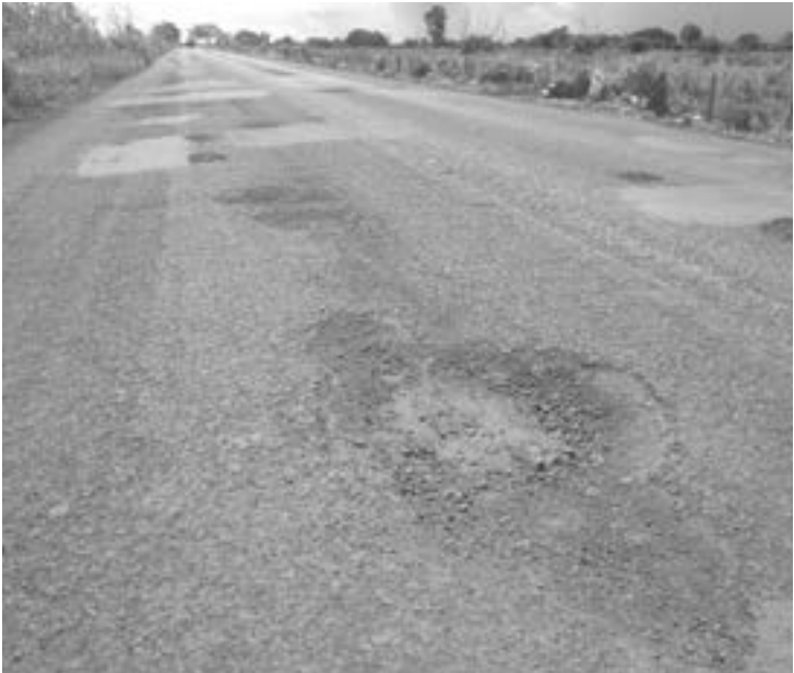
Anel Viário está esburacado
