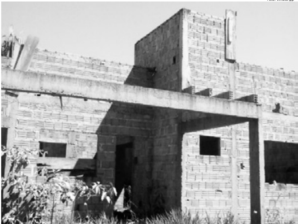
Suposta casa abandonada está localizada na rua 42, no Jardim Acapulco
