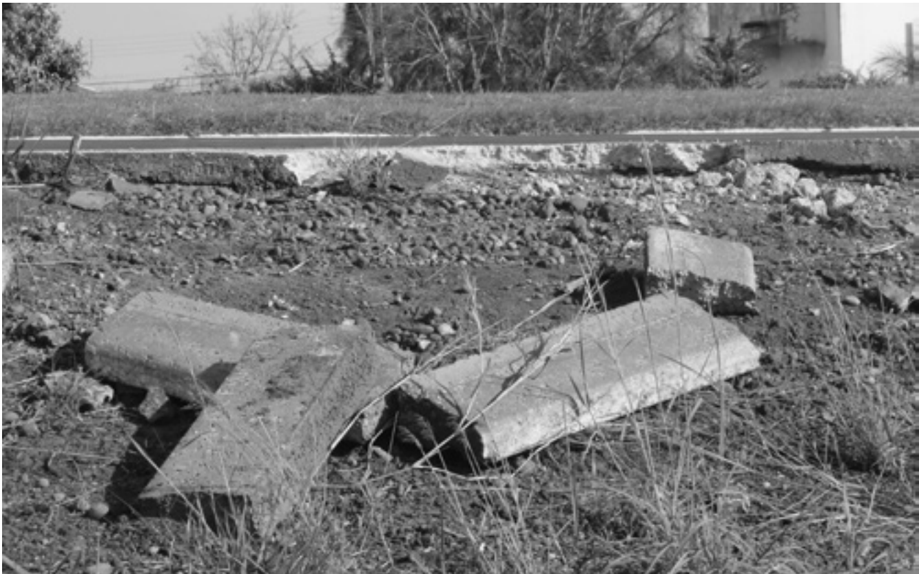
Meio-fio quebrado, buracos, placas ao chão são alguns dos problemas
