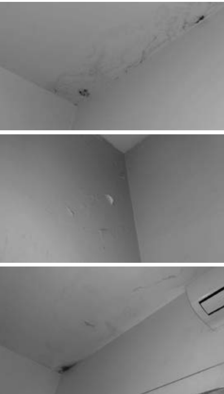
Salas com infiltrações
