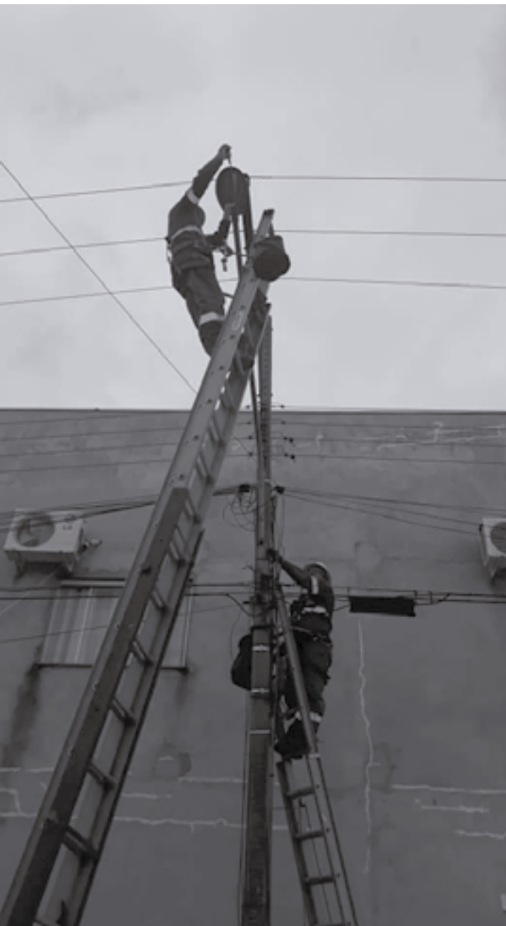
Município realiza manutenção das lâmpadas
