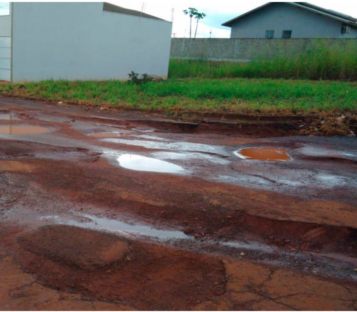
Ruas do Jardim Itália estão em situação precária
