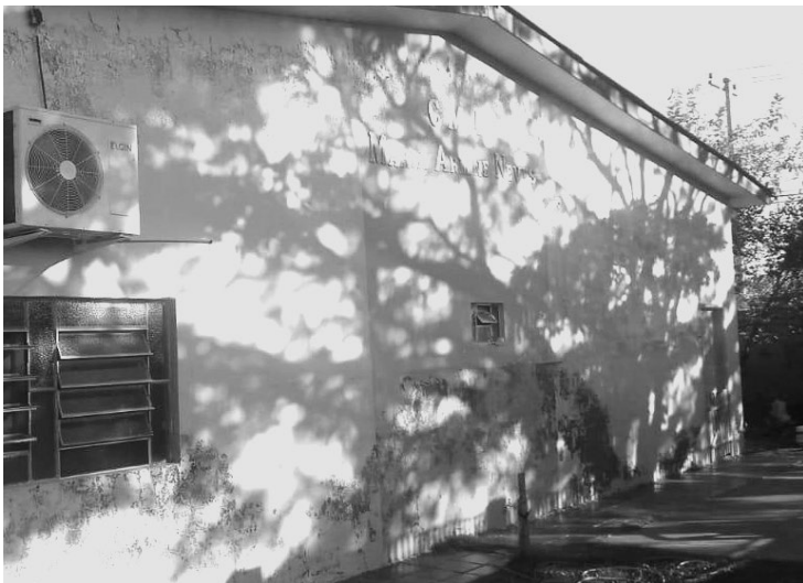
Escola está em situação precária
