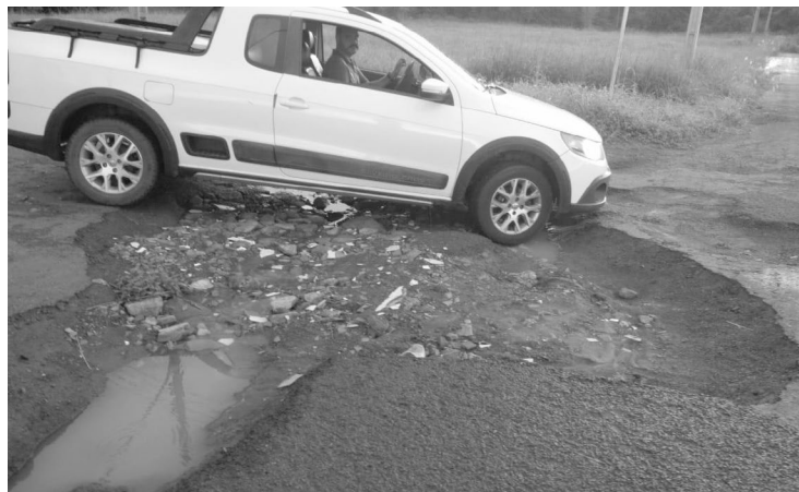
Situação de ruas no Jardim Itália está caótica
