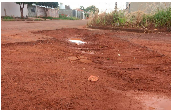
Asfalto está em situação precária
