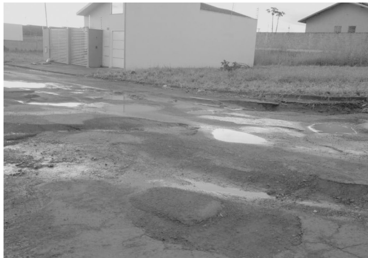
Asfalto está em situação precária
