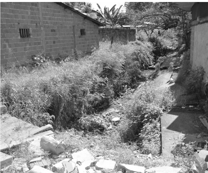
Residências muito próximas do canal
