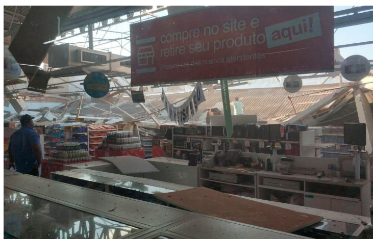
Telhado cedeu, ferindo duas vítimas
