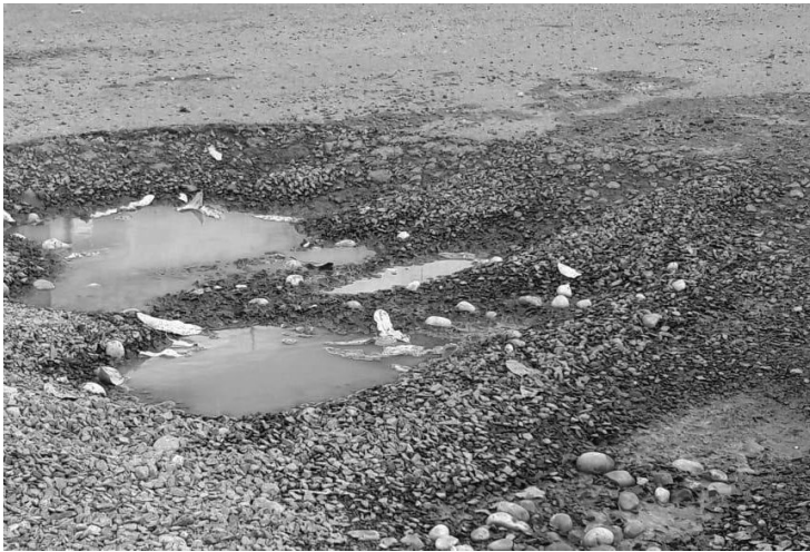
Buracos espalhados nas ruas da Tarumã, Califórnia e Tangará II
