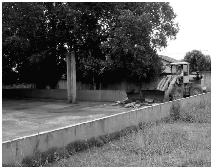
Empresa arrancou estrutura antiga e abandonou as obras
