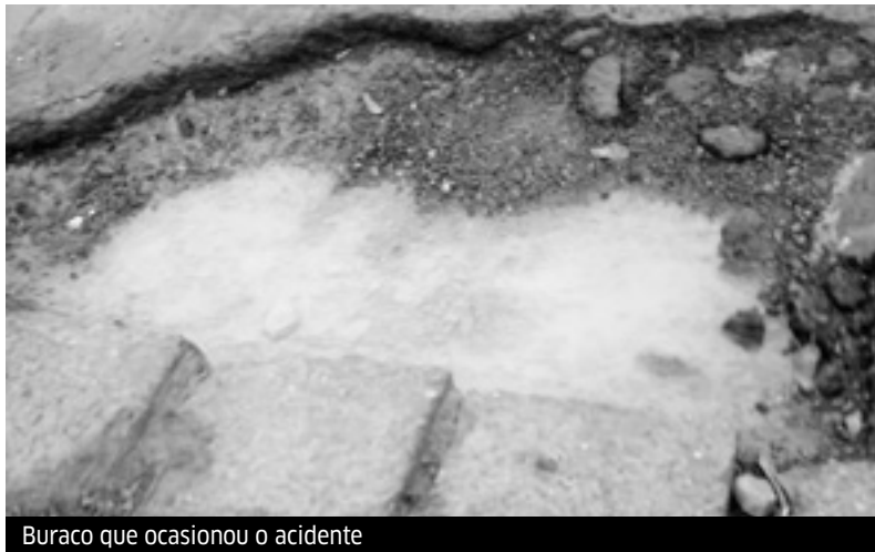
Buraco que ocasionou o acidente
