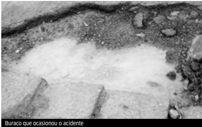
Buraco que ocasionou o acidente
