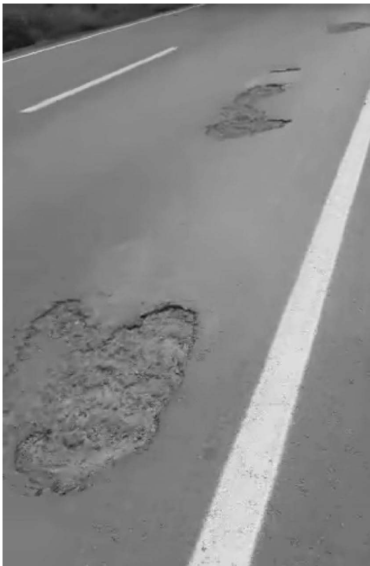
Trecho já apresenta buracos
