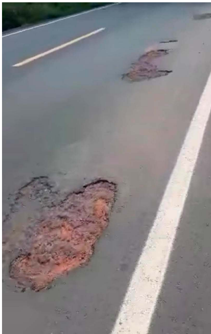
Trecho já apresenta buracos
