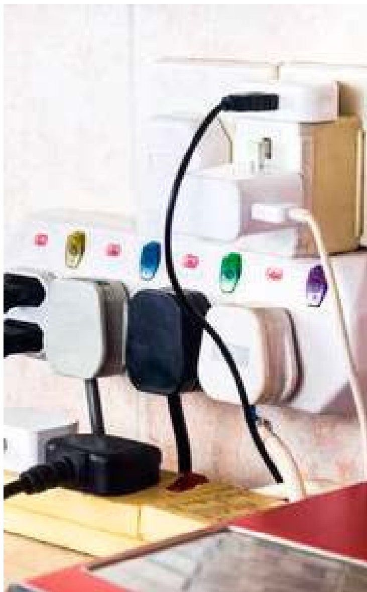
Benjamin (T) com vários itens pode ocasionar curto-circuito
