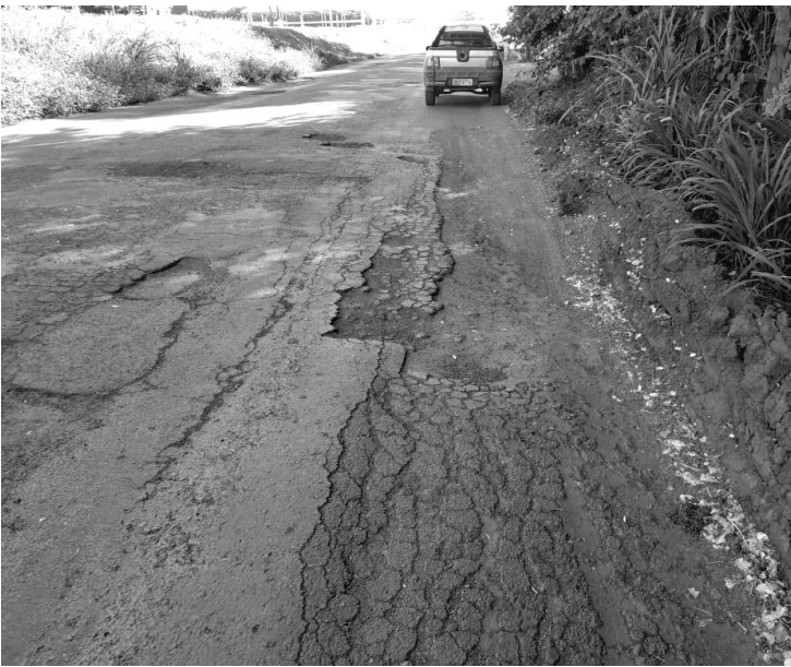
Trecho apresenta muitos buracos
