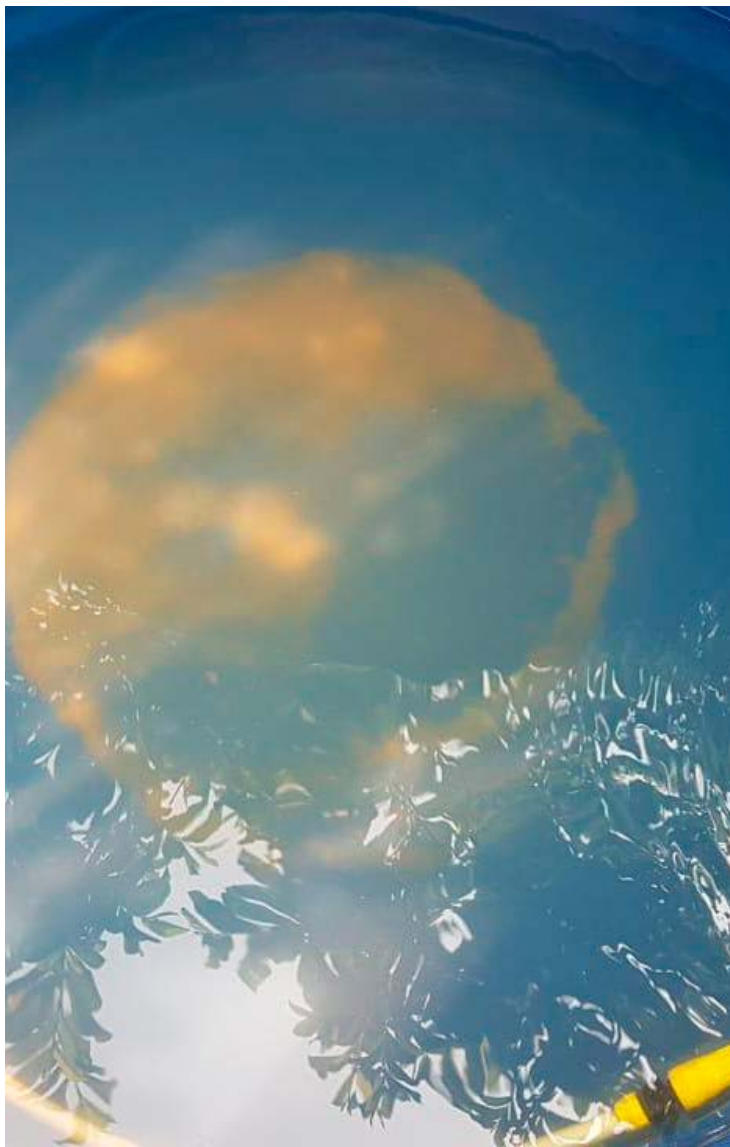
Lama no fundo da caixa d'água
