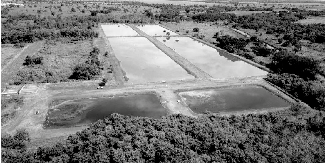
Estação de Tratamento de Esgoto
