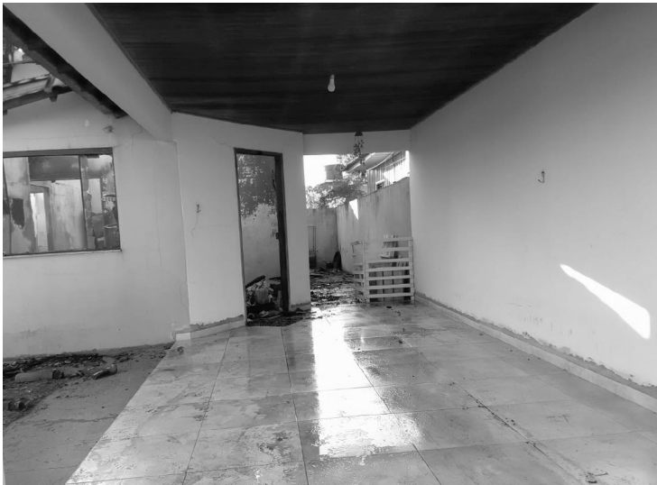
A casa foi totalmente destruída pelas chamas
