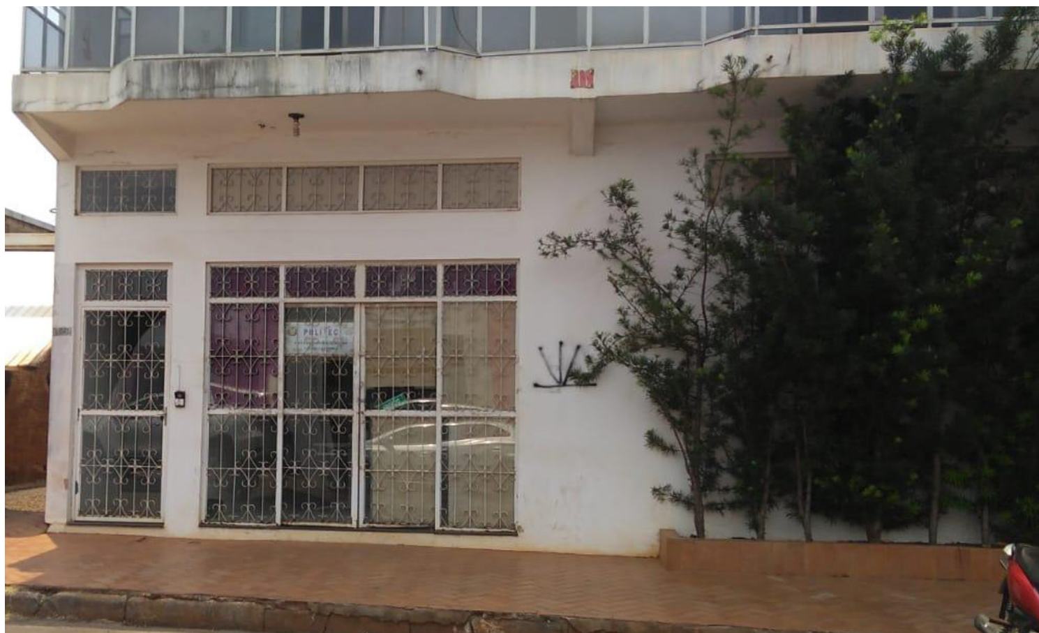
Prédio público sem acessibilidade
