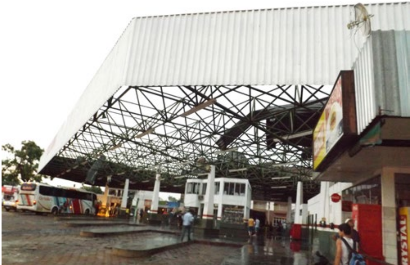
Terminal rodoviário ficou totalmente destelhado
