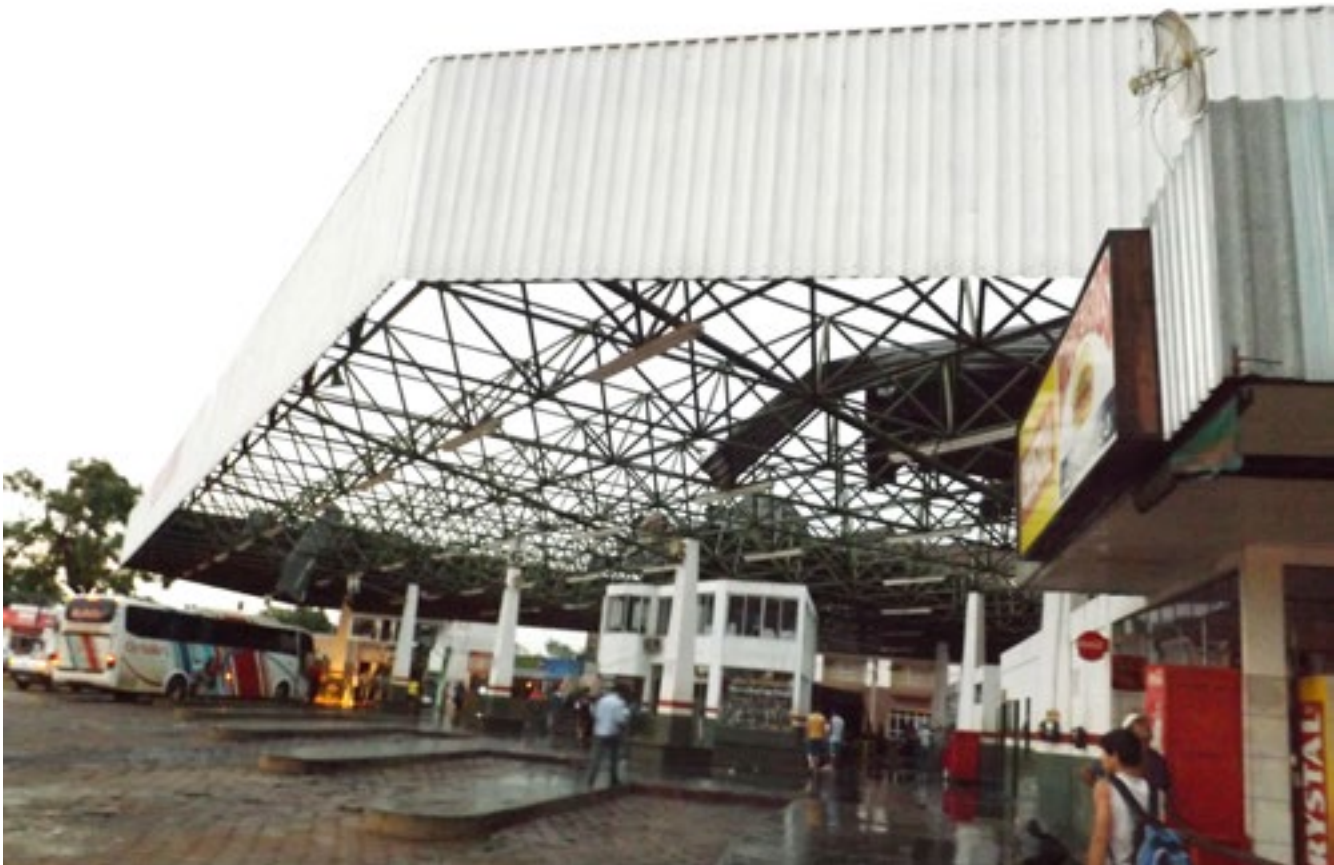
Terminal rodoviário ficou totalmente destelhado
