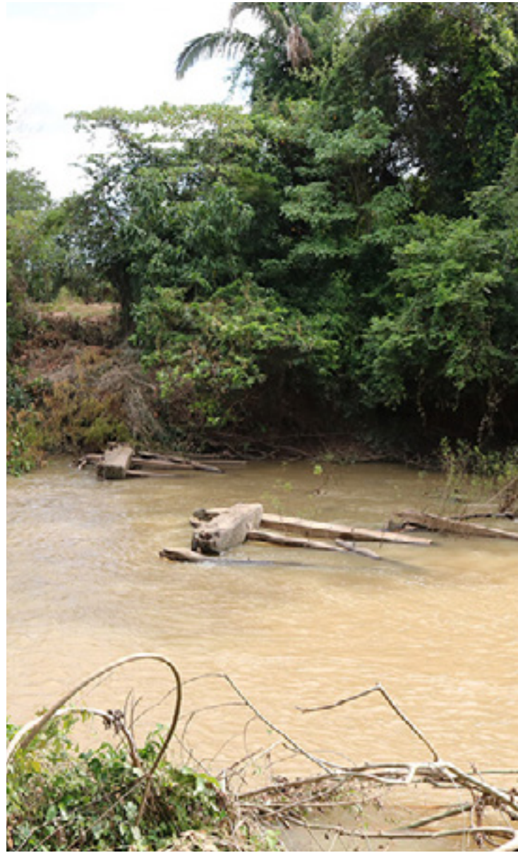
Passarela sobre o rio foi rompida no início do mês
