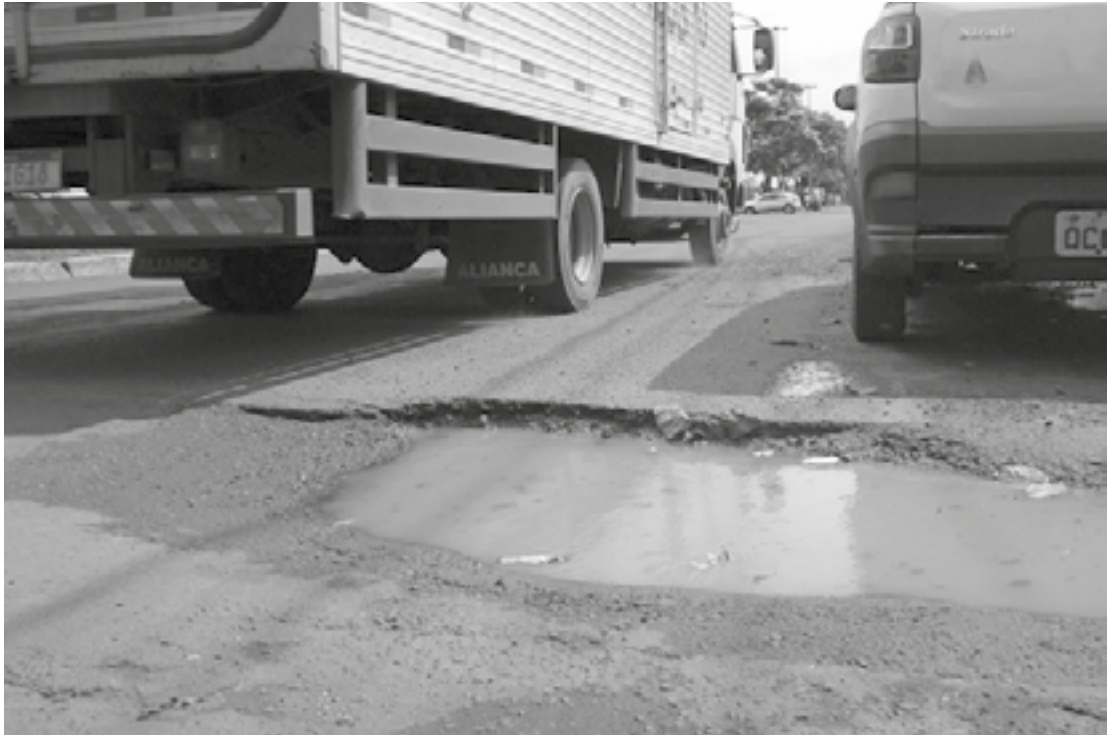
Asfalto desgastado e com muitos buracos
