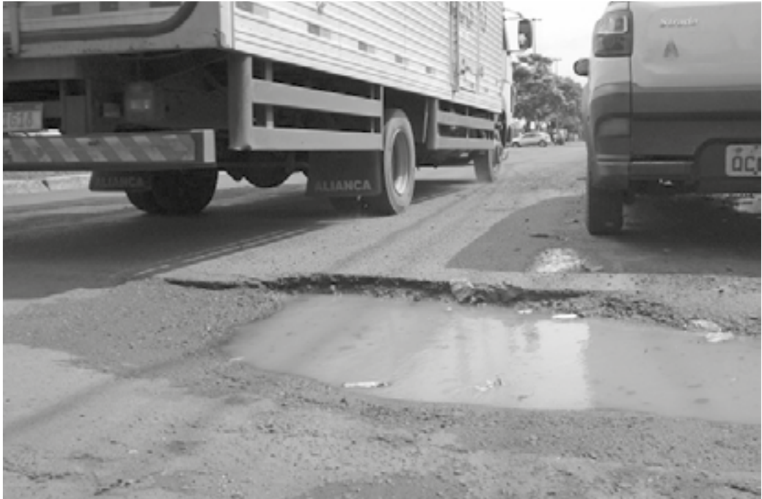
Asfalto desgastado e com muitos buracos
