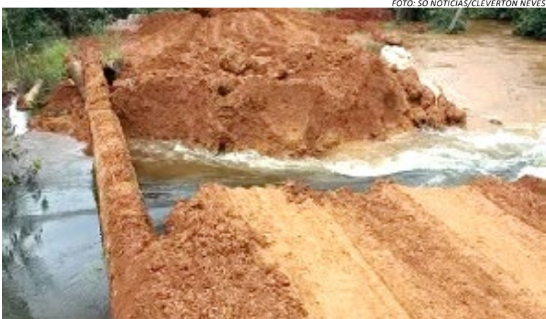
Pontes em condições precárias devem ser substituídas
