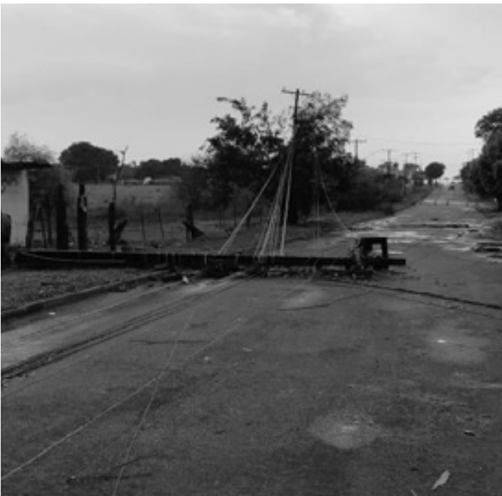
Caíram 12 postes de iluminação pública
