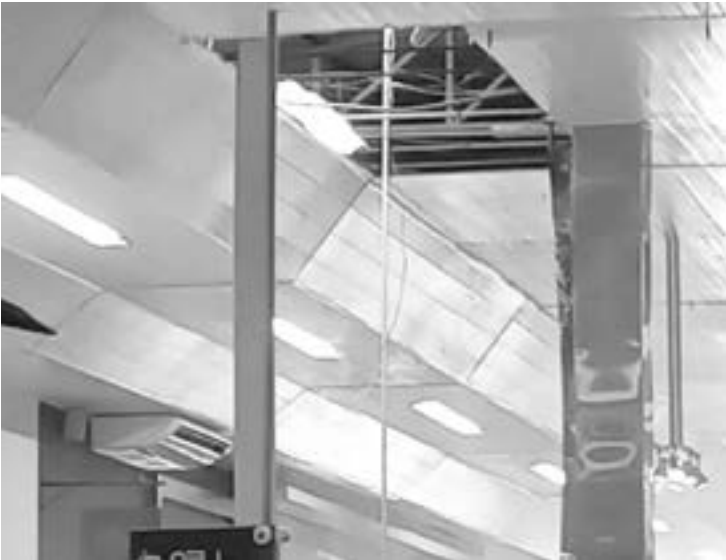
Estrutura cedeu com o peso do trabalhador
