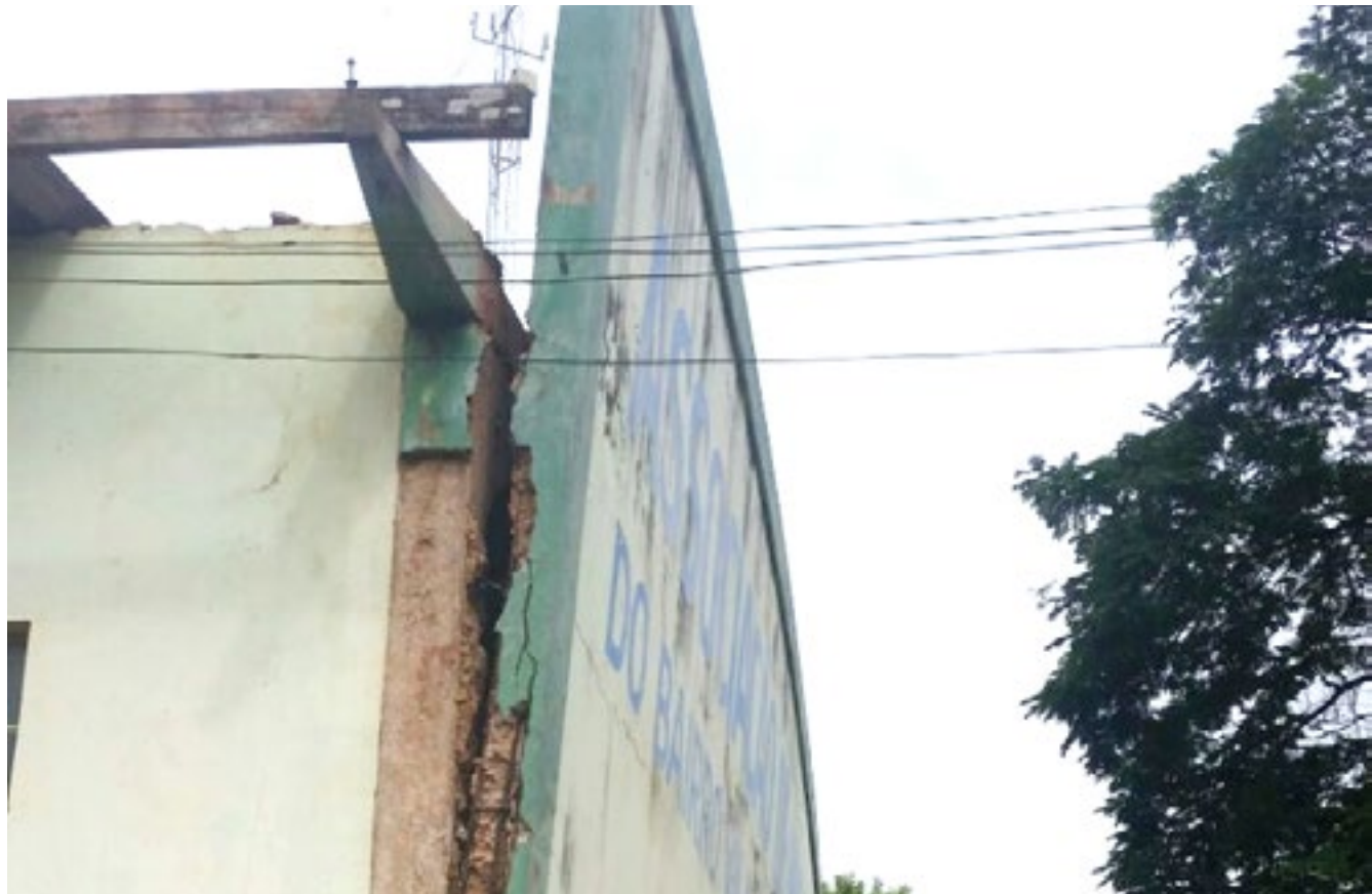
Parede de salão comunitário está quase caindo. Local também foi atingido
