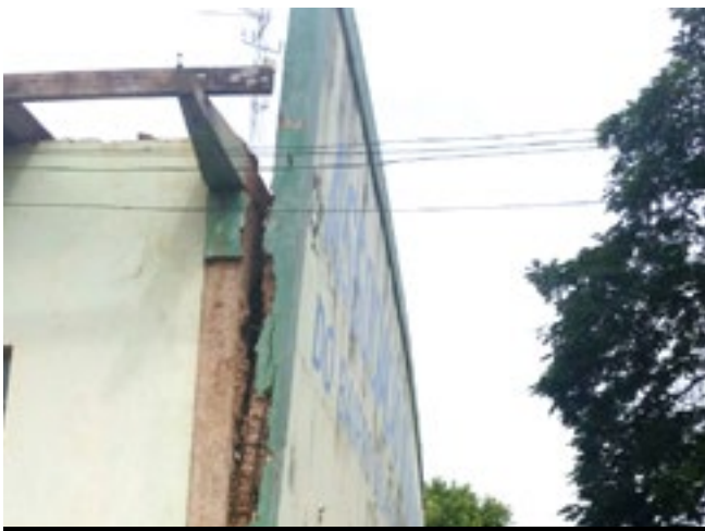
Parede de salão comunitário está quase caindo. Local também foi atingido
