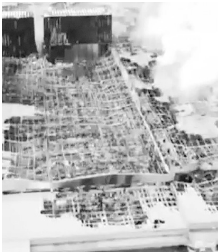
Imagens aéreas mostram estrutura danificada em frigorífico
